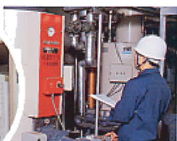
ボイラー設備
