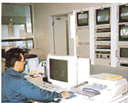
中央監視設備
