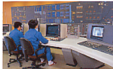
中央監視設備
